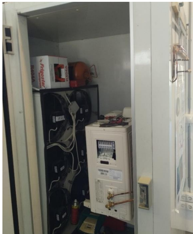
3.4. ábra A kültéri egység elhelyezése a kamrában, baloldalt az átkeverő ventilátorokkal
