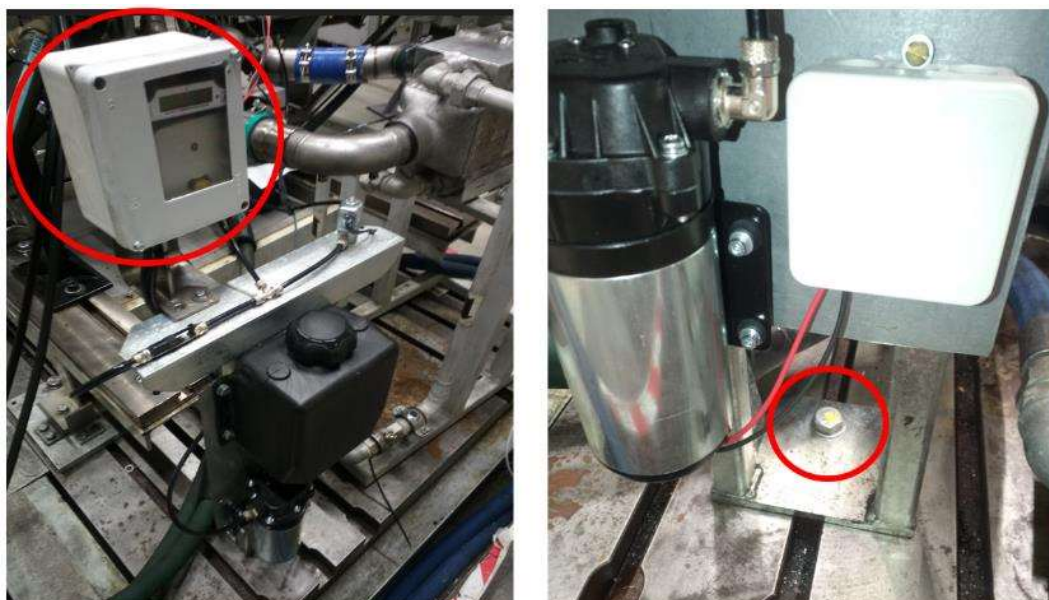
3.15. ábra: A vízbefecskendező rendszer védő borítása és az oldható kialakítás
